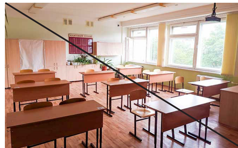
Плохо Линолеум под дерево
